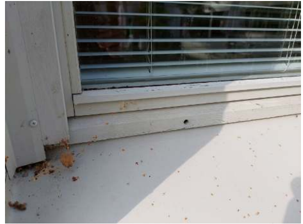
70. Puupinnoissa on havaittavissa kulumaa.
