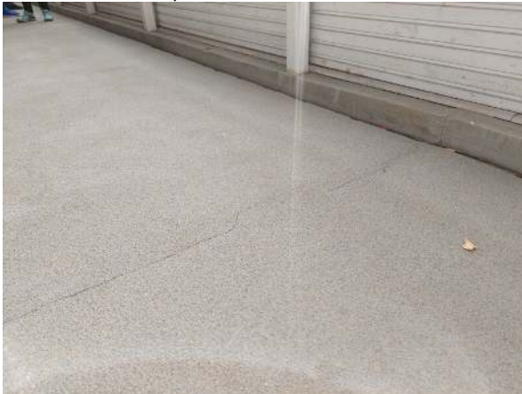
80. Parvekelaatassa oleva halkeama.
