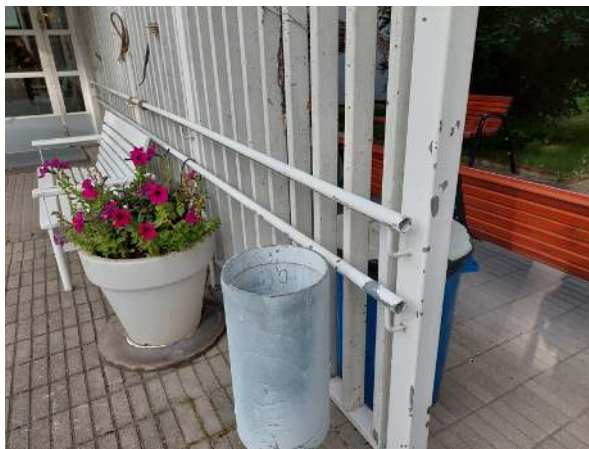
38. Pihan teräsrakenteissa on havaittavissa kulumista.
