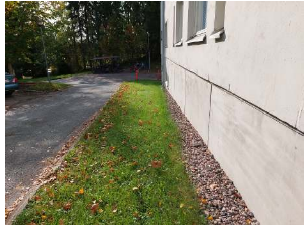
10. Maanpintojen kallistuksissa havaittiin lieviä puutteita.
