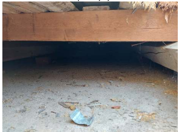
104. Yläpohjassa ei havaittavissa lämmöneristettä.
