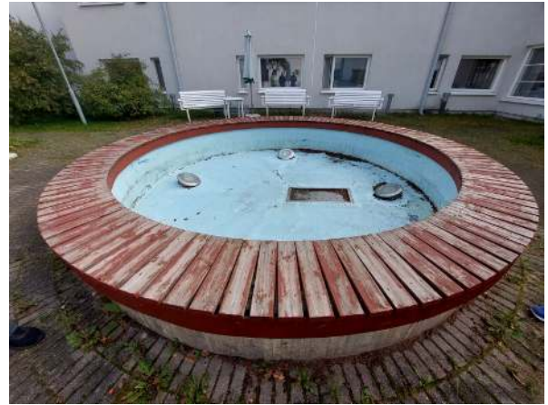
37. Käytöstä poistettu suihkulähde.
