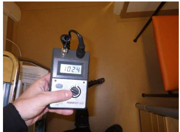
6. Pintakosteusmittarilla tehtyjä poikkeavia havaintoja uusimman osan lattiarakenteesta.
