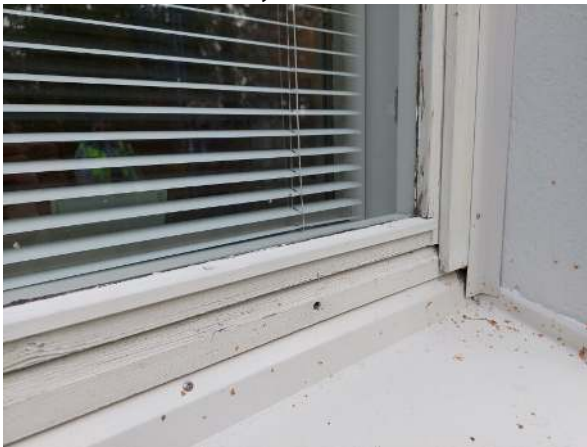
71. Puupinnoissa on havaittavissa kulumaa.
